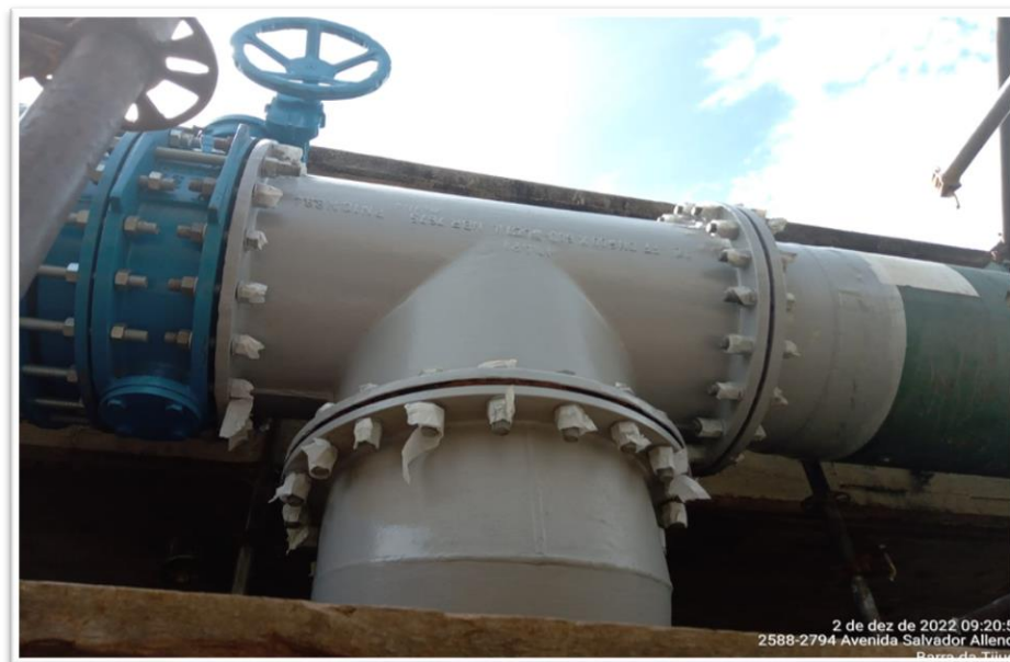
Interligação próxima a Ilha Pura
