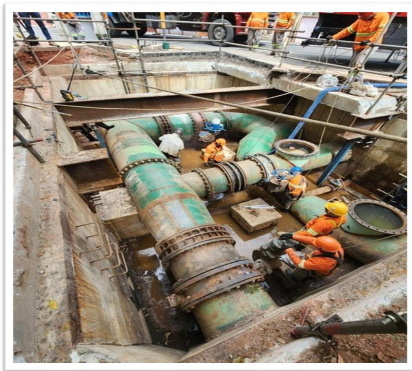
Interligação do reservatório Outeiro
